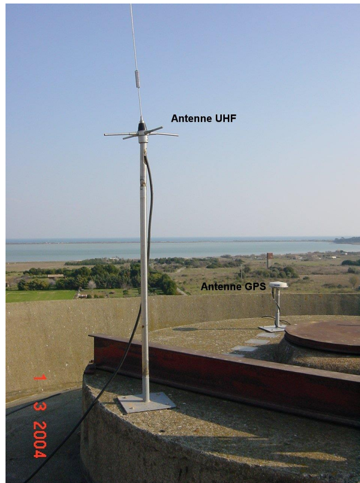
Photo 4 - Station GPS du château d'eau de Vic-La-Gardiole
